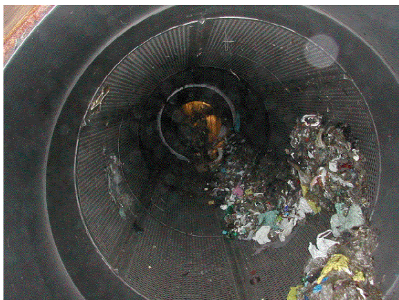
Figure 18 : Progression de la matière dans un trommel à 25 mm
